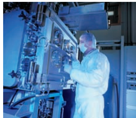
In einen Reinraum integrierte PACVD-Anlage zur Herstellung hochreiner DLC-Schichten
